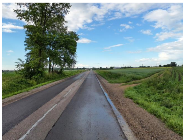
Ryc. 4. Środek przeznaczonego do remontu fragmentu DW 690 pod Czyżewem
